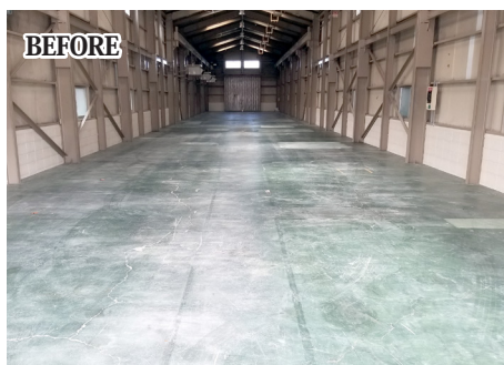
■倉庫 使用製品：床塗料シリーズ 密着!! 油まみれでも（グリーン）
