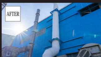
スレート壁面を工場の稼働を止めることなく補修・補強
